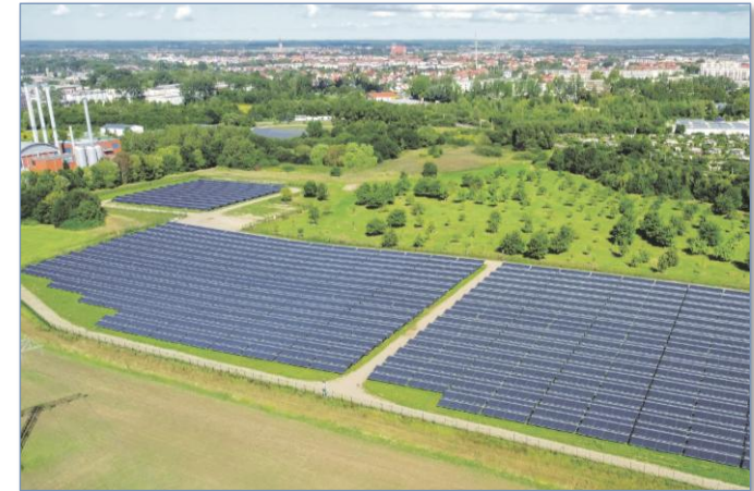
Stadtwerke Greifswald Source: Ritter XL Solar
