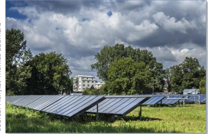
Fernheizwerk Graz (FHW) Source: Picfly.at Thomas Eberhard
